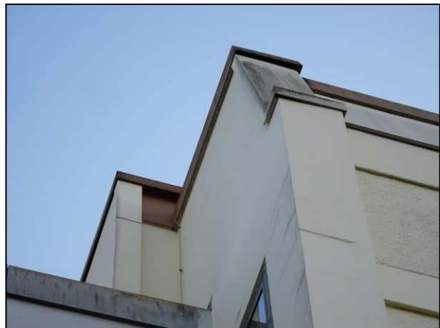
Abb. 7: Dachaufbau mit vielen Schlitz und Hohlräumen an der Verkleidungskonstruktion.
