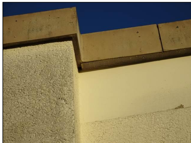
Abb. 21: Selbe Stelle Abb.20 An den Kanten sind im Lochblech Lücken erkennbar.
