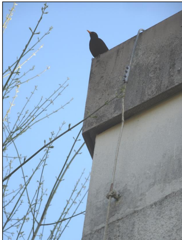
Abb. 25: Kapelle (Stelle unterhalb Amsel mit Lücken zwischen der Dachstruktur).
