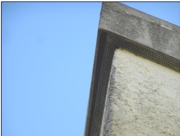
Abb. 24 (oben): Kapellendach mit Spalte am Lochblech.
