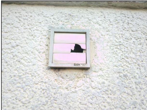
Abb. 10: Defekte Plastikverkleidung an der Westseite der Kapelle. Hier Verdacht auf brütende Sperlinge.
